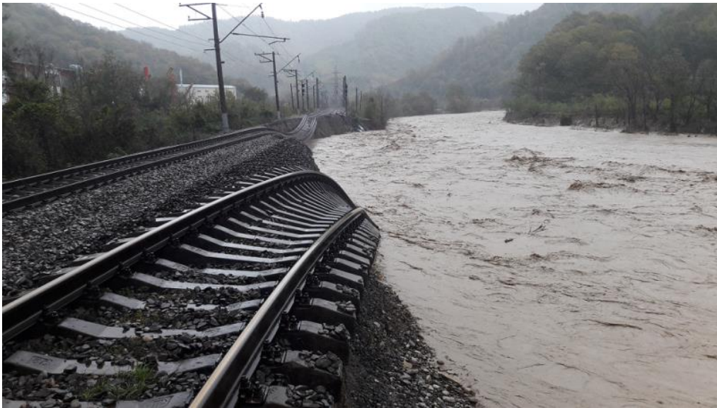
Рис. 6. Повреждение железнодорожного пути в районе Туапсе из-за сильных дождей и паводков вдоль реки Туапсинка в октябре 2018 года (Kostianaia et al., 2021)
